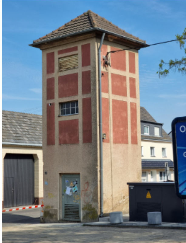
Trafoturm am Pater-Bertram-Platz / Foto: Keßler
